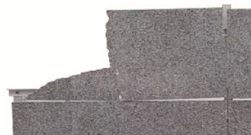
无防坠背网石材破碎坠落
